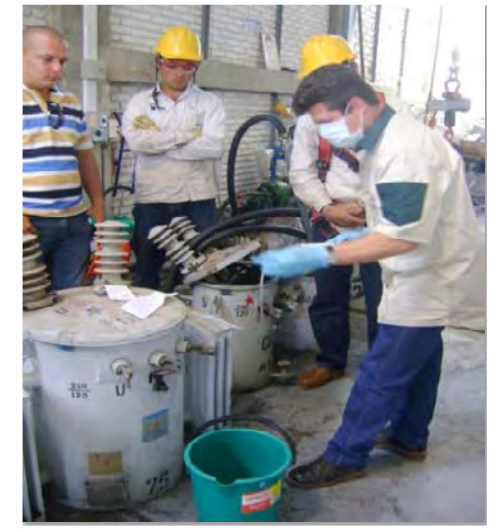
Toma de muestras en transformadores en uso (en poste) y en desuso.
