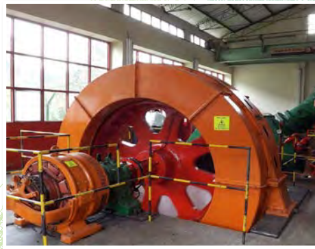
Equipos existentes PCH Intermedia
