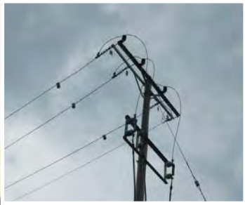
Indicadores de falla
