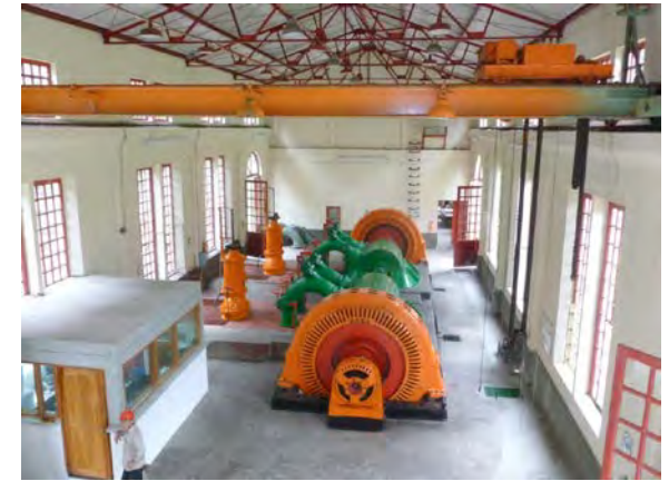
Equipos existentes PCH Municipal
